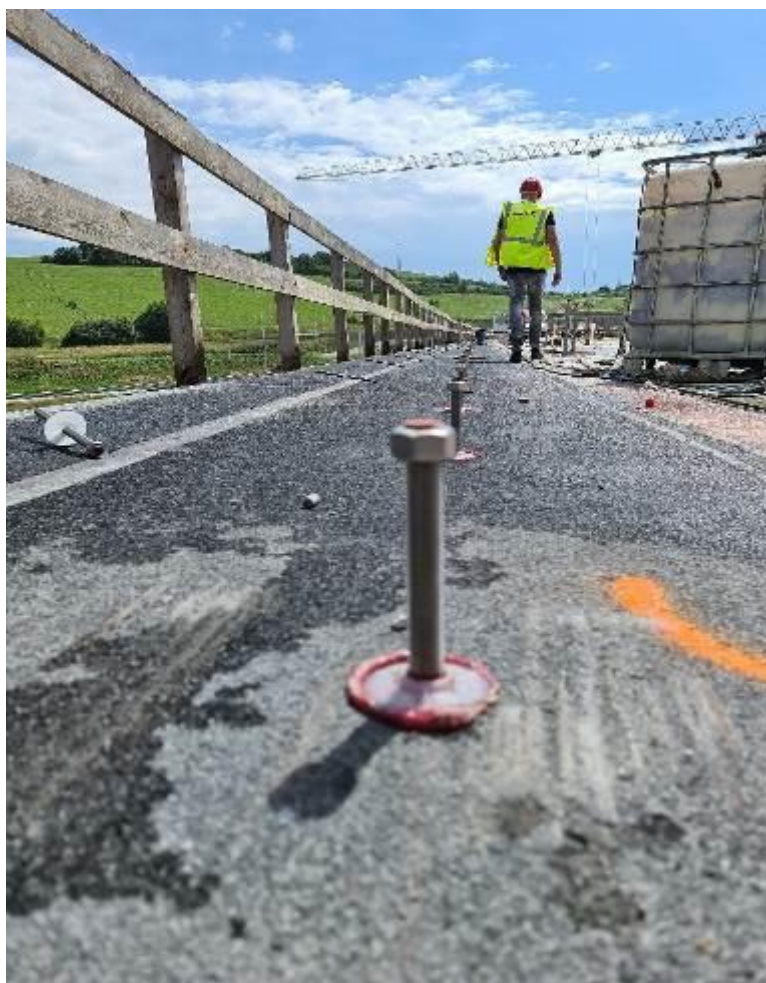
Obr. 5 Pohľad na zabudovaný systém rímsových kotiev HPA na moste 201-00
