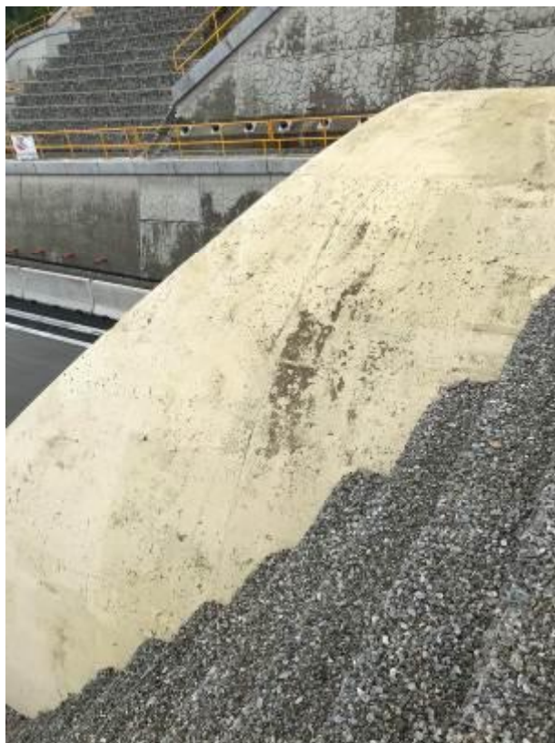
Obr. 10 Pohľad na úpravu portálov rovnakým materiálom ako ostenie nevhodné riešenie – degradujúci náter v krátkom čase
